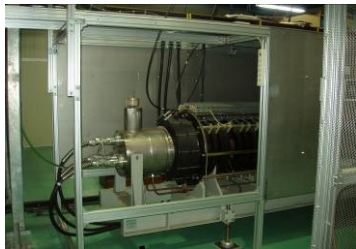
Klystron for RFQ 350MHz 1MW CW
